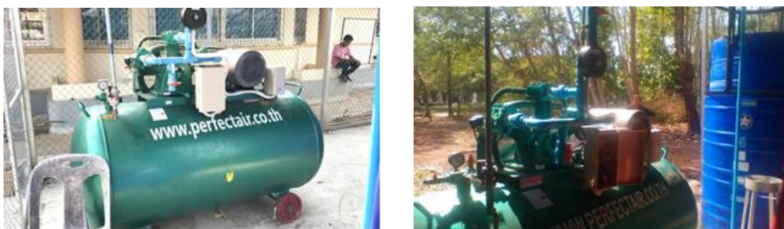
ภาพแสดงการติดตั้งชุดเสริมประสิทธิภาพลดการใช้ไฟของเครื่องอัดก๊าซชีวภาพของชุมชนต้นแบบ
